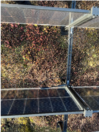
Abbildung 16: Verkabelung auf dem Dach
